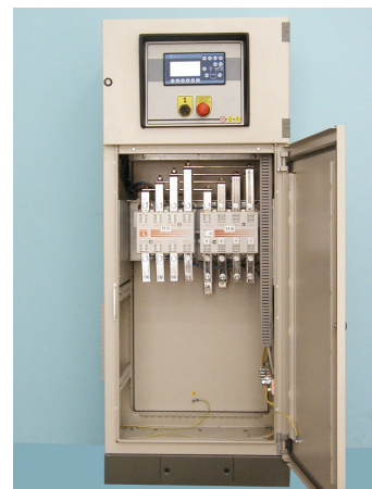
Sterowanie automatyczne TE804 z szafą SZR
